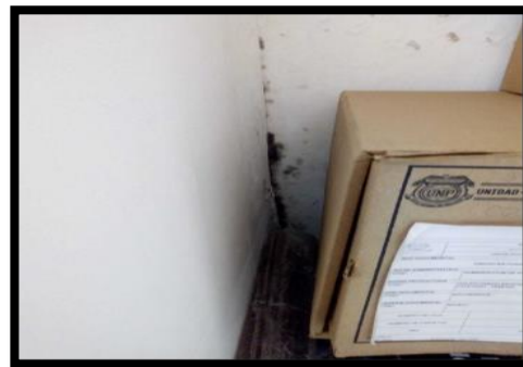
Área con humedad
