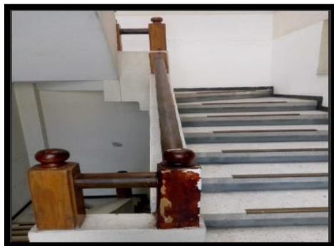
Escalera al 4to piso en estado regular
